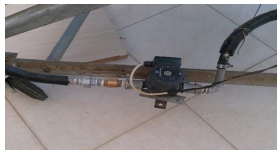
شکل ۲- محل نصب پمپ گردفوس در سامانه مورد آزمایش
