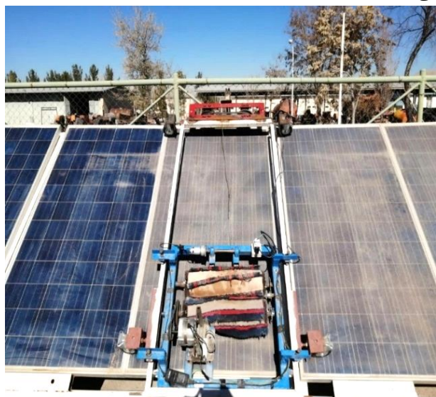
شکل ۵- مجموعه ماشین تمیزکننده مکانیکی در حال کار روی سطح آرایه. ماشین تمیزکننده شامل سکوی تمیزکننده (قاب آبی رنگ)، ریل هدایت کننده (سفید رنگ) و حامل‌های چرخ روی پنل (قرمز رنگ)
