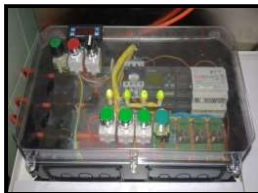
شکل ۴- جعبه مدار فرمان و قدرت شامل (پی‌ال‌سی، منبع تغذیه، شیرهای برقی، رله‌ها، کنتاکتور و سویچ‌های اصلی و فرمان)
